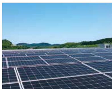
太陽光発電所 (福岡県宮若市)
