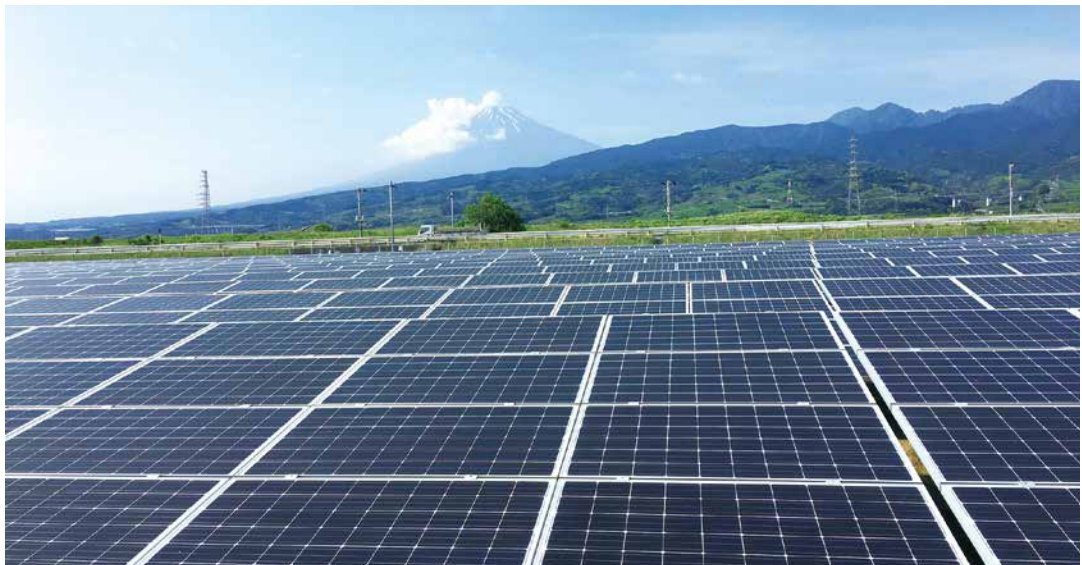
〈沼津太陽光発電所(静岡県沼津市)〉
